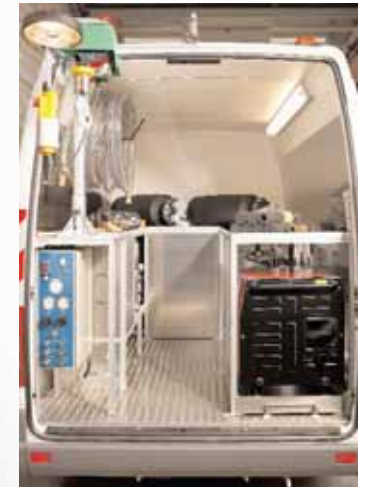
Einbauanlage zur Haltungsprüfung Wasser / Luft mit separatem Kran zum Ablassen der Prüf- und Absperrmaterialien.
